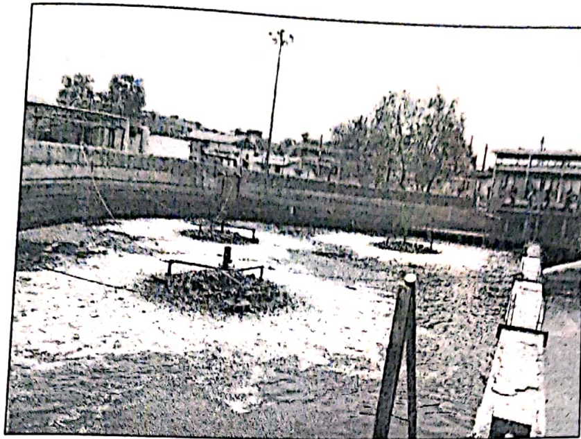
Photo : Equalisation Tank
